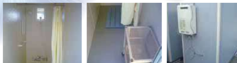
ハンドシャワー(KS-内装) バスマット 脱衣2段カゴ(KS-内装) 給湯器(KS)
